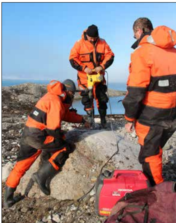
Josef Stemberk, Filip Hartvich a Jan Blahůt při instalování bodu GNSS pro měření geodynamických pohybů, Hornsund fjord. Foto M. Hladká ÚSMH AV ČR
